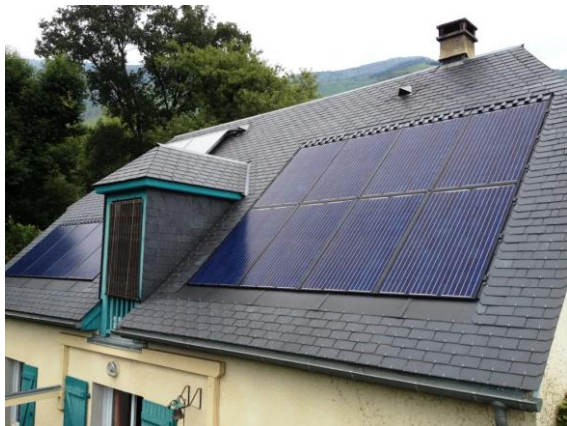
Panneaux intégrés en toiture
